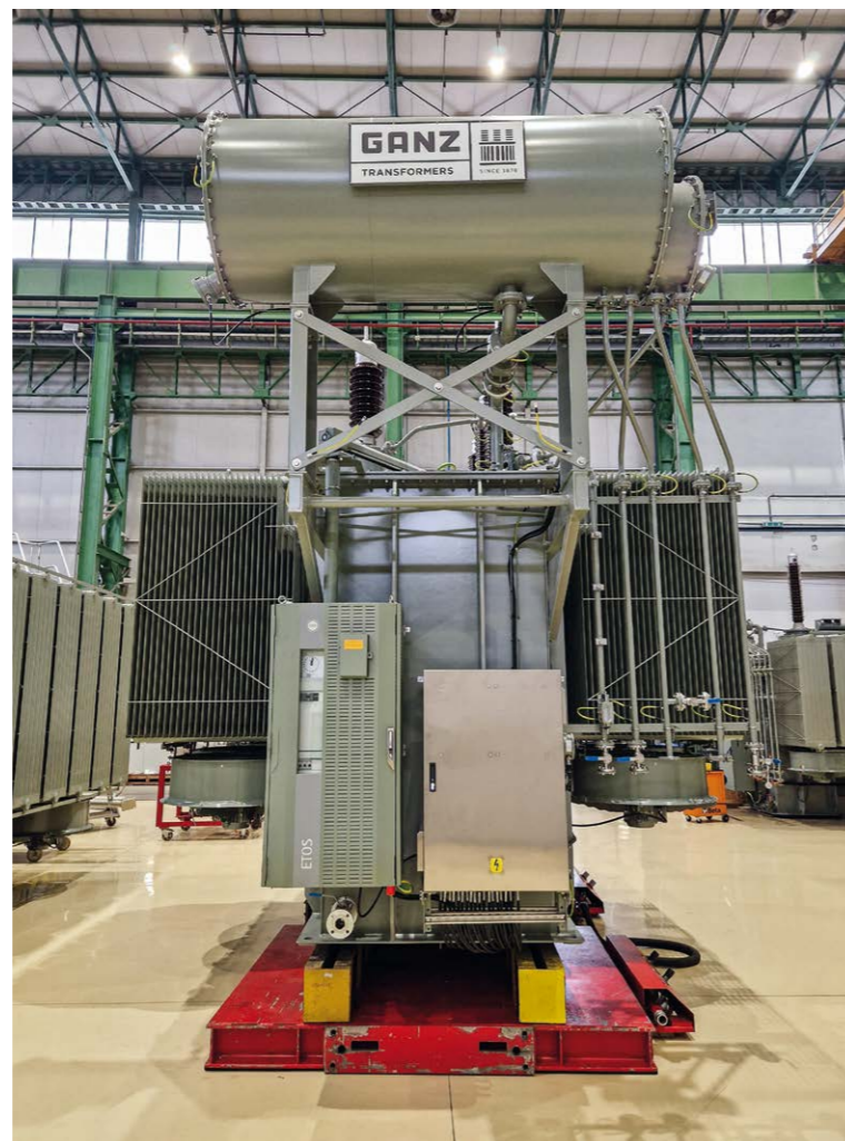
» Az intelligens rendszer segítségével elérhetővé válik a transzformátorok állapotfüggő karbantartása
