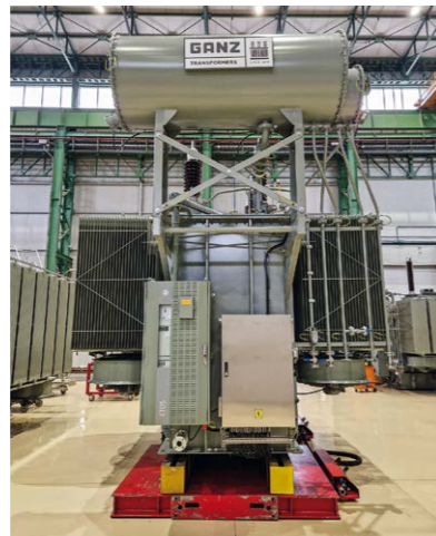
» A digitális monitoringrendszerrel felszerelt transzformátorok élettartama meghosszabbítható
